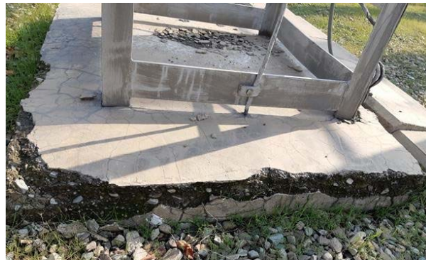
تصاویری از پایه بتنی تخریب شده
